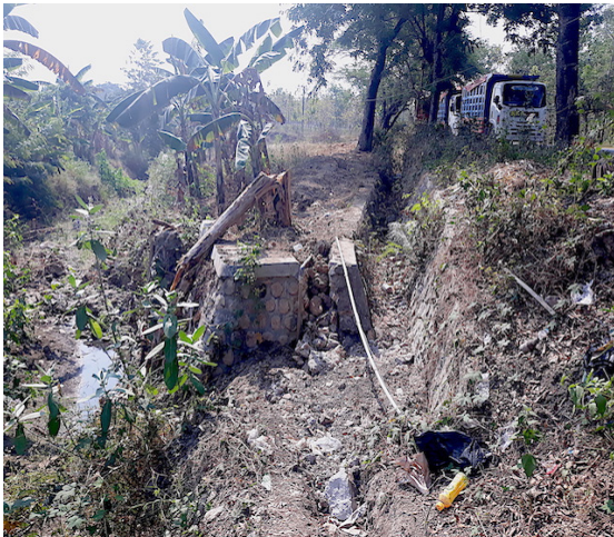
Gambar 7. Kondisi tebing sungai di sisi barat dari jalan raya provinsi
